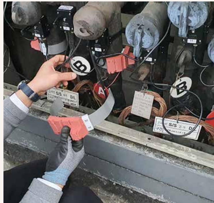
Installation von Sensoren in einer Mittelspannungsschaltanlage.
